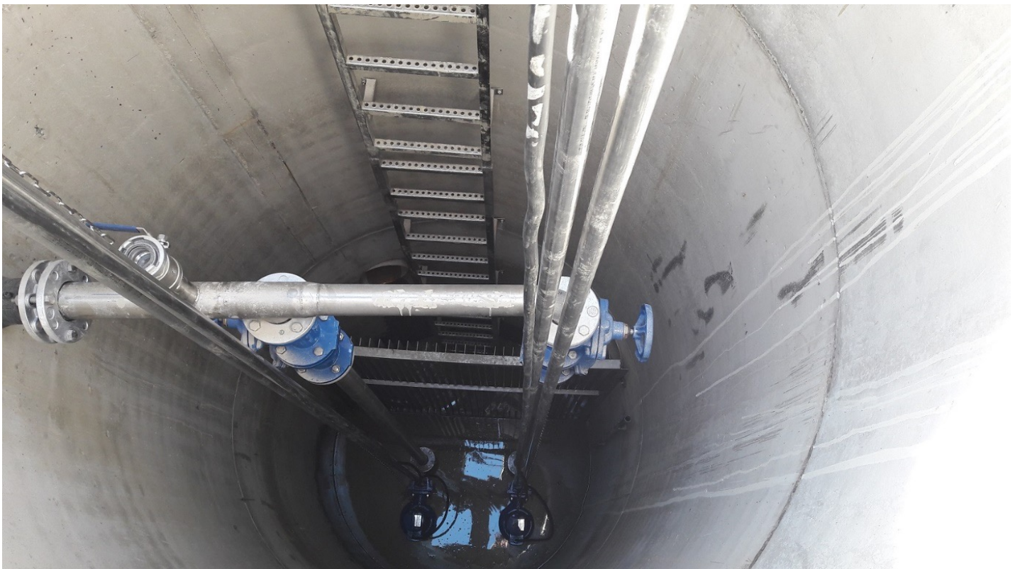
Obr. 2 Vnútorné vystrojenie kanalizačnej čerpacej stanice
