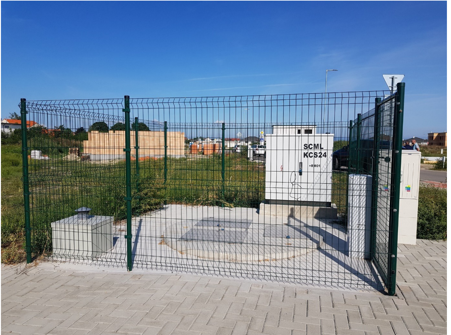
Obr. 1 Kanalizačná čerpacia stanica
