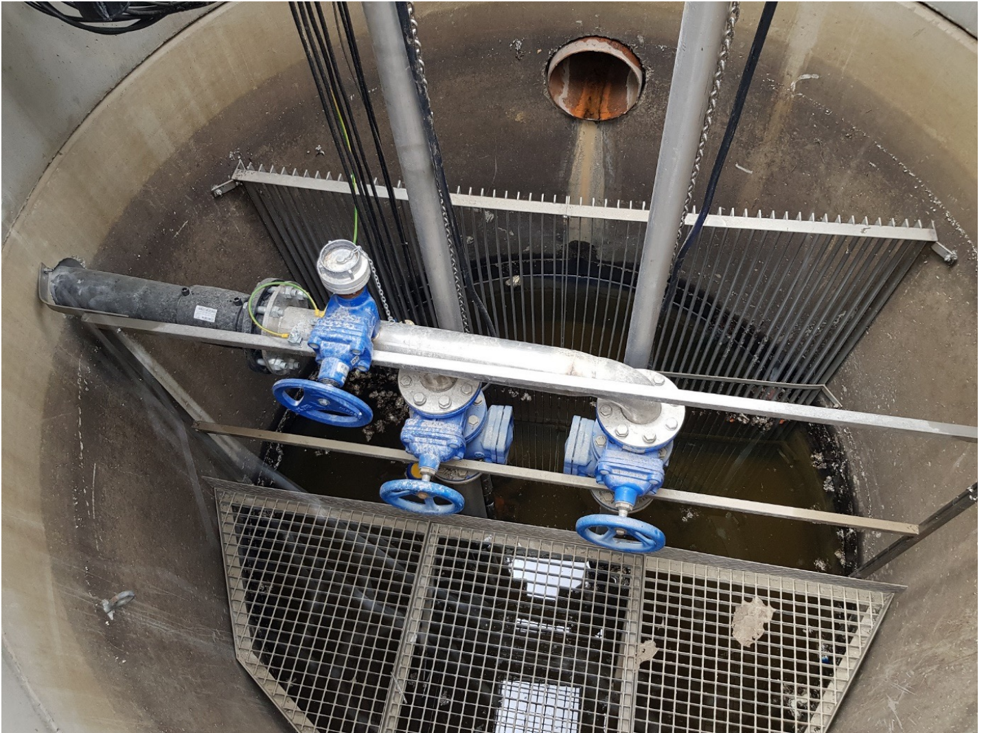
Obr. 3 Vnútročné vstrojenie kanalizačnej čerpacej stanice
