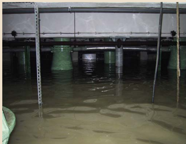
Zaplavený suterén ČS Karlova Ves 15. augusta 2002
